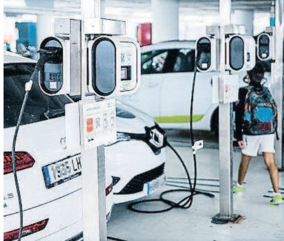
Puntos de recarga en un parking de Barcelona
